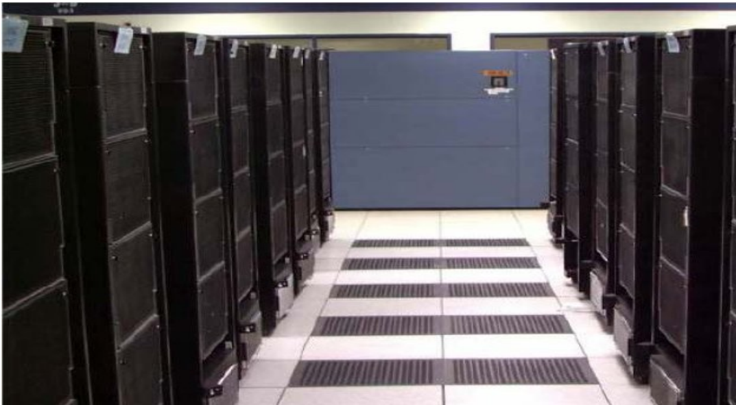
Figura 2. Disposición de equipos en pasillos y losetas de alimentación de aire frío (tomado de referencia [4])
